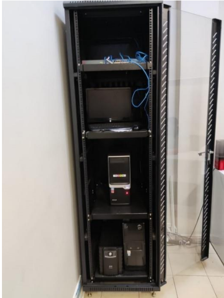
Figura 13: Data Center da CMA
